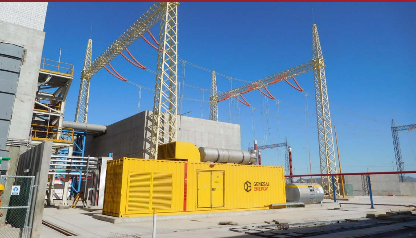
GRUPO DE EMRGENCIA BLACK START DE 2.000 KVA
